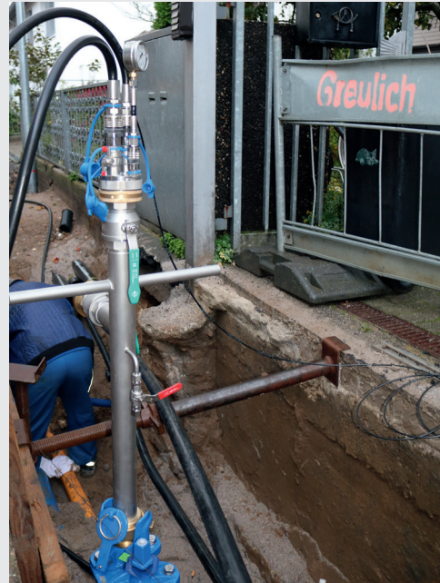
Bild 8: Kontraktions-Druckprüfung: Messaufbau mit Prüfstandrohr und Prüfkörper L
